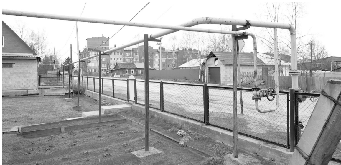
Подведение газопровода до земельного участка и подключение к сетям — бесплатно, работы внутри земельного участка ведутся за счет средств собственника.
